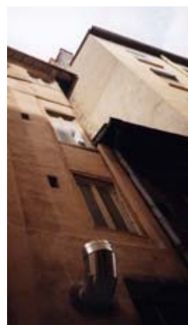
Ventilation non conforme
